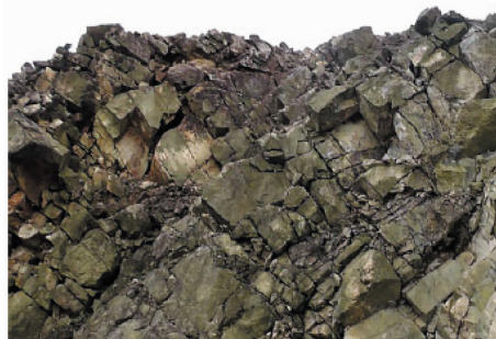
图 6 裂隙显著张开的岩体
