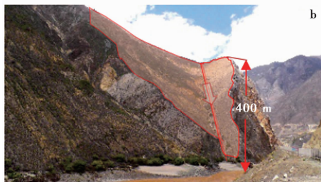
图 7 斜坡局部与整体破坏
