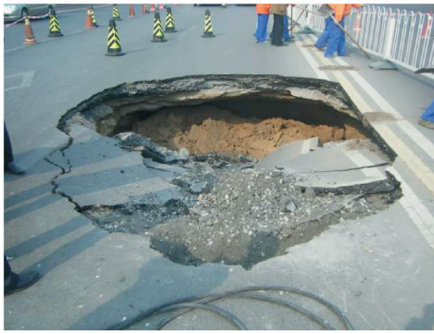
图8 雨水渗漏引起的地表塌方
