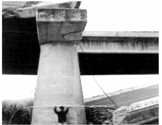
图 2 由于纵向位移产生的上部结构倒塌
