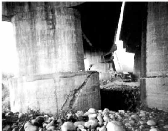
图4 剪切裂缝 Fig. 4 Shear cracks
