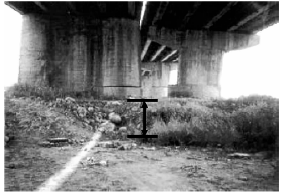
图 1 桥墩之间产生的断裂位移
